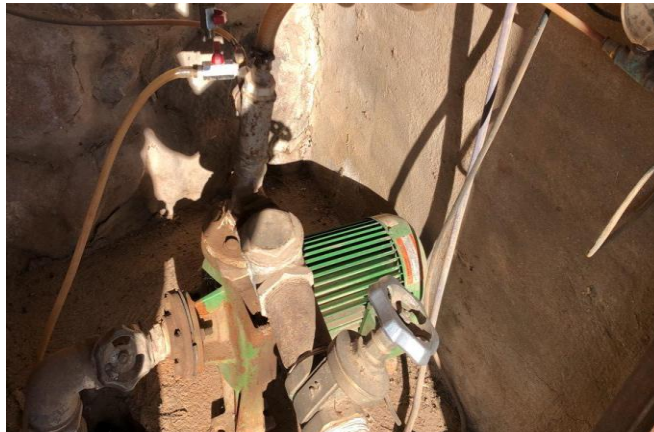
Imagen 5: Sistema de Bombeo Pozo Petrini
